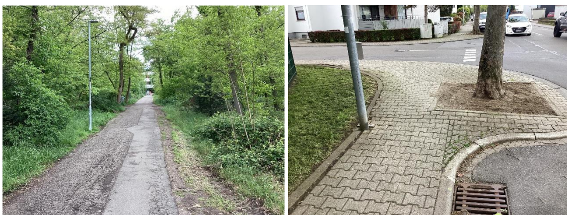
Abbildung 32: Beispiele für Oberflächenschäden
